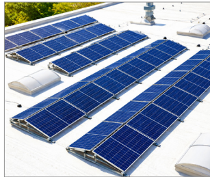
auf Anlagen mit bifacialen Modulen
